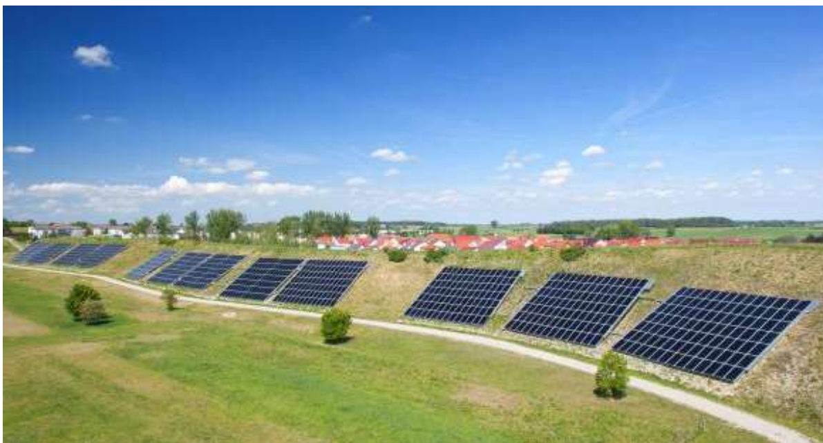
Abbildung 3.4: Freiflächen-Solarthermieanlage in Crailsheim [www.sonnewindwaerme.de/solarthermie/solare-waermenetze-baden-wuerttemberg]
